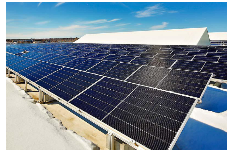
Les panneaux solaires installés sur le toit du Centre de traitement Albert-Jackson produisent de l'énergie renouvelable
